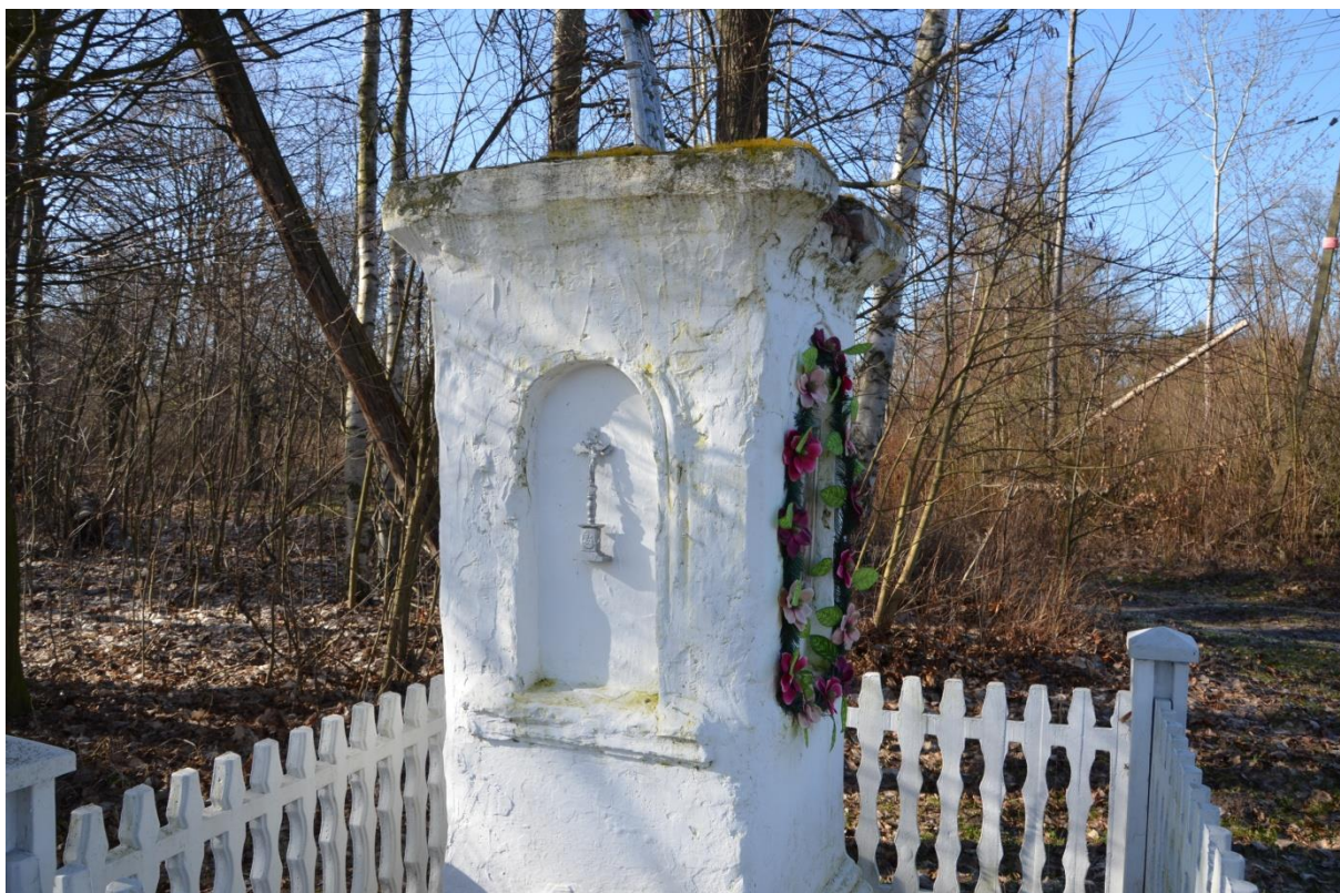
Fot. 3 Widoczny wielokrotnie zacierany tynk
