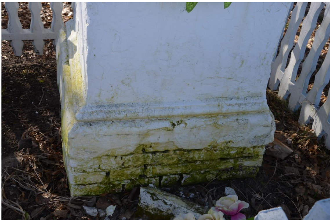
Fot. 1 Cokół: zniszczony tynk odsłaniający cegłę, liczne drobnoustroje
