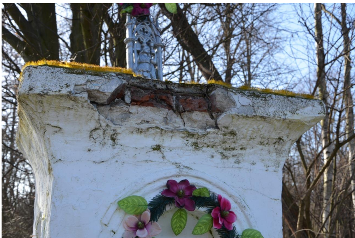
Fot. 2 Zniszczony tynk, pęknięcia, osypująca się oraz rozwarstwiająca cegła, porosty na dachu
